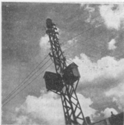
Conductă electrică (Carașova, U.D.R.)
